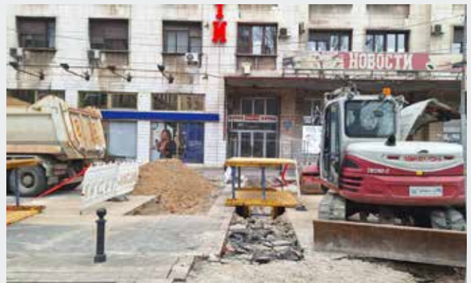
Екипа БВК на отклањању квара
